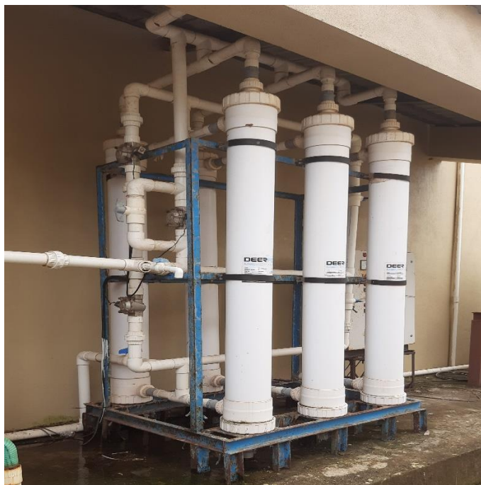
Ultrafiltration Membrane Unit
