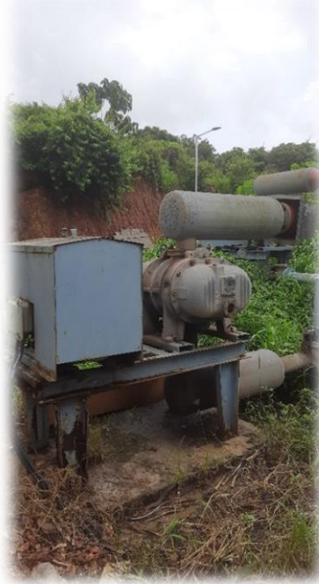
Air blower E 67C
